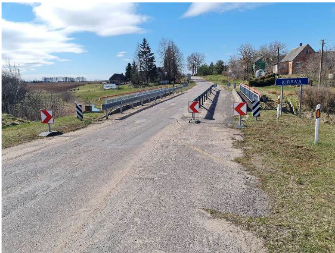
Pav. 5 Tilto paklotas ir defektai
