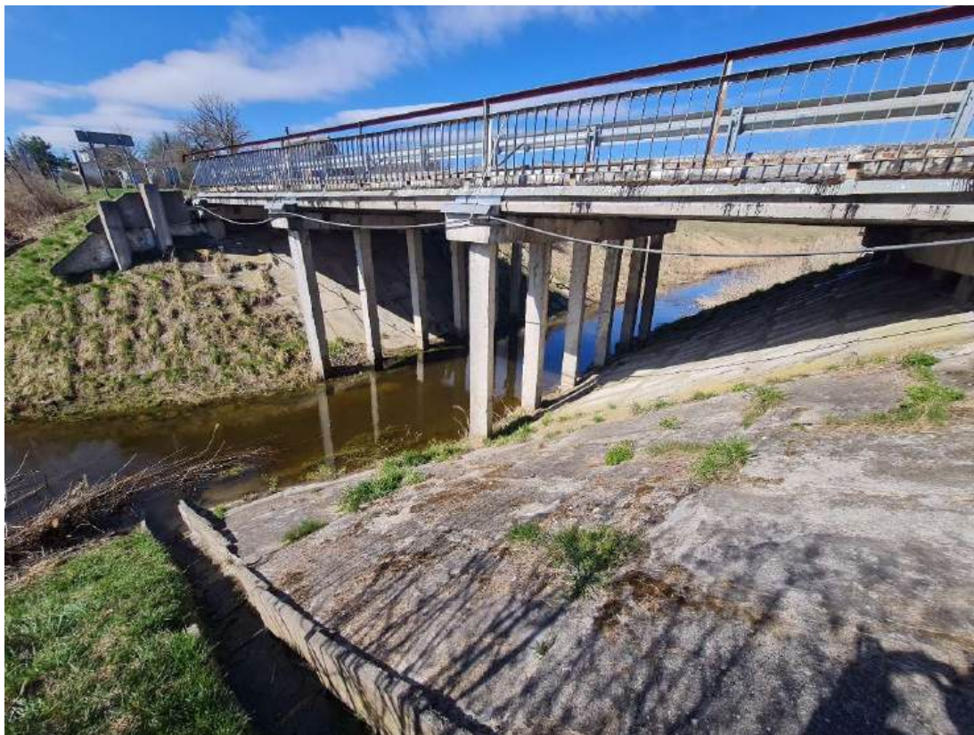
Pav. 4 Tilto fasadas, surūdiję turėklai ir pažeidimai betono konstrukcijose, deformacijos kūgiuose
