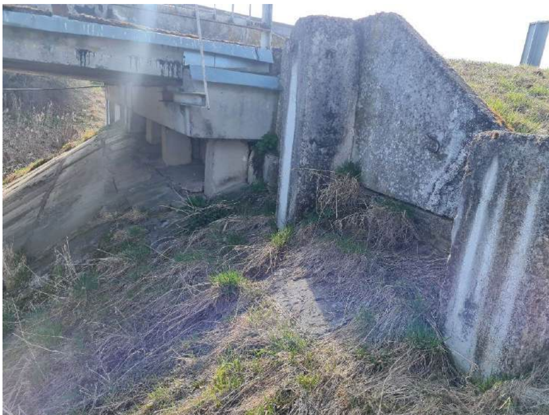
Pav. 6 Pažeidimai krantinėse atramose ir deformacijos atraminėse sienose
