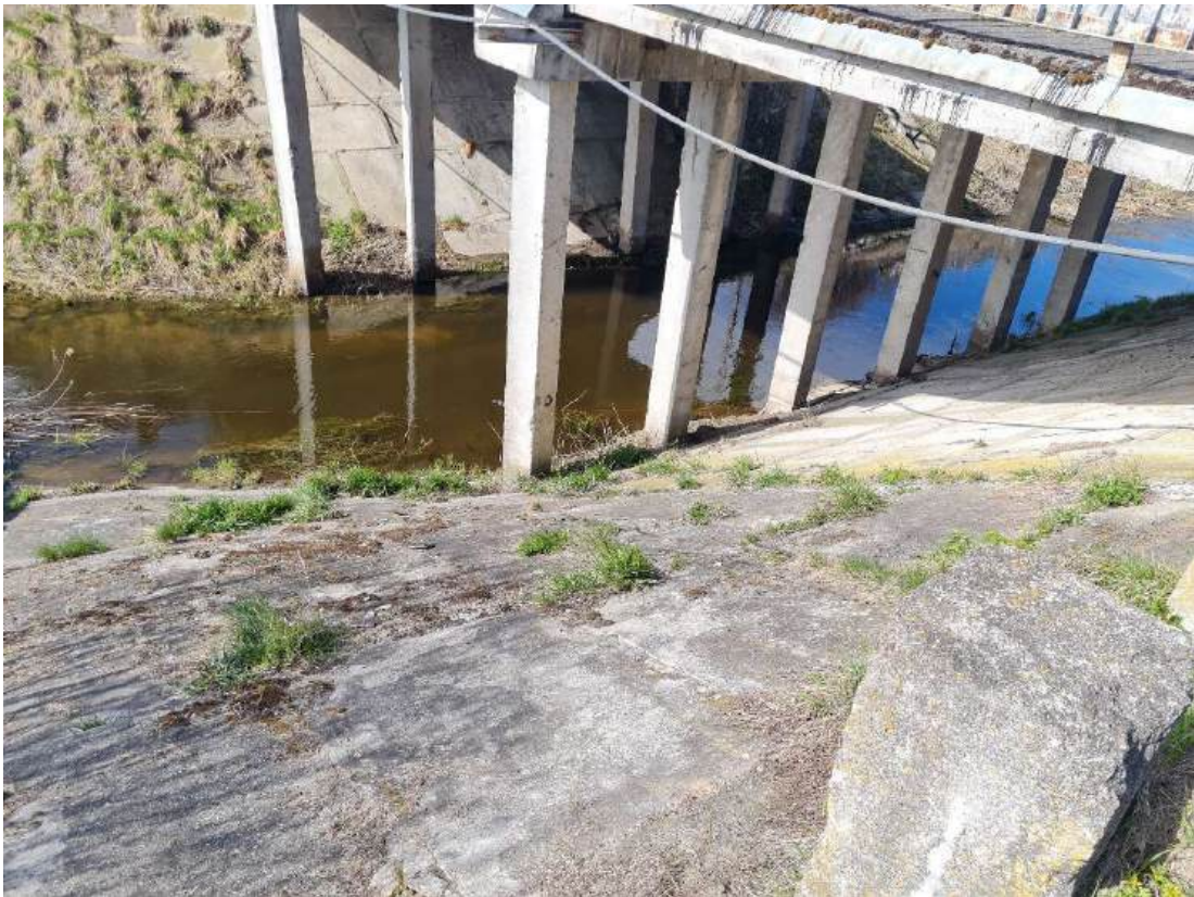
Pav. 8 Upės vagos po tiltu būklė.
