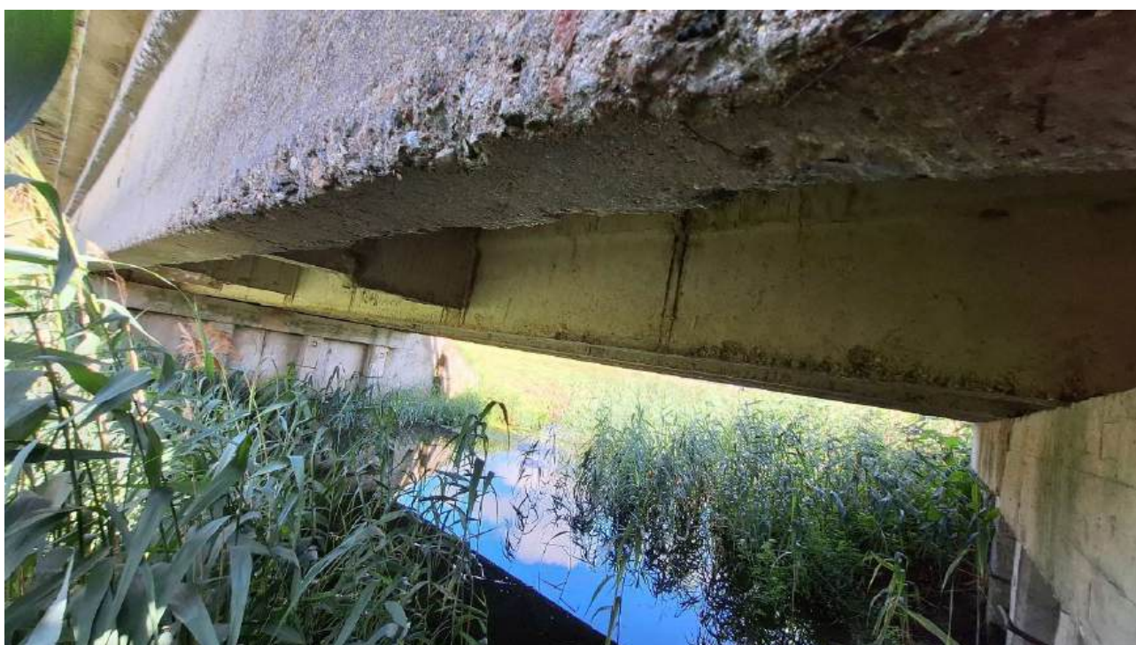
Pav. 22 Tilto defektai kraštinėse sijose ir krantinėse atramose.
